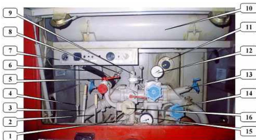
Рис. 11.1 Насосный отсек пожарной автоцистерны АЦ-3,2-40(4331)8ВР
